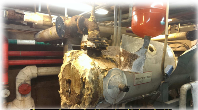
Osa vanhaa vedenlämmitysjärjestelmää
