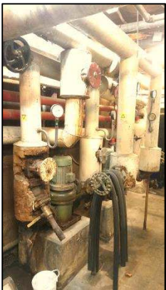
Osa korjausta tarvitsevasta lämmitysjärjestelmästä
